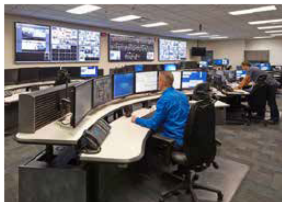
Figura 1 - Sala controllo con strumentazione digitale
